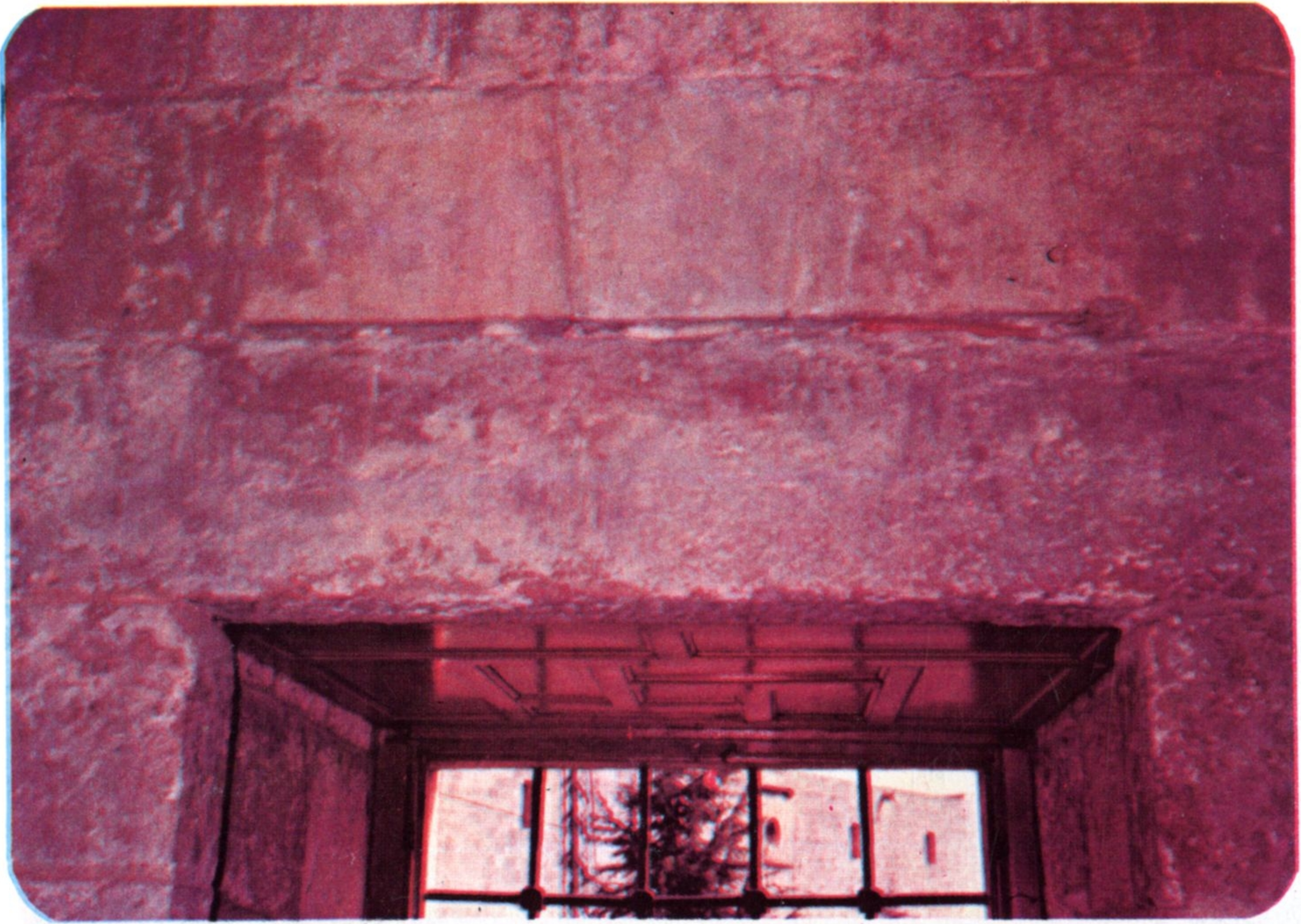
صورة ٥٧ - الحائط الجنوبي - تفاصيل عتب الشباك
