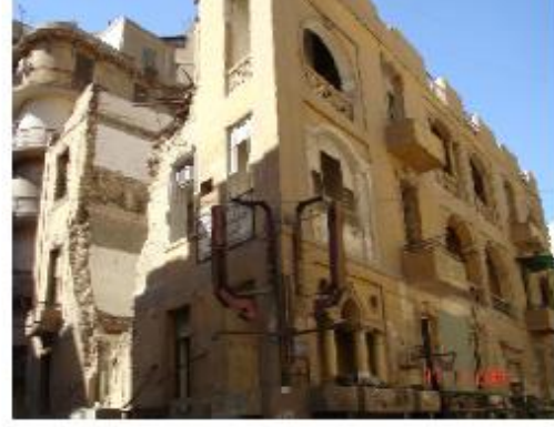
شكل (١): مبنى تراثي ذو قيمة حدث له تخريب وهدم متعمد ش ناصر الدين مع البستان (يوليو ٢٠٠٦) المصدر: الدليل الإرشادي للجهاز القومي للتنسيق الحضاري الجزء رقم (١) ، أسس ومعايير التنسيق الحضاري للمباني والمناطق التراثية وذات القيمة المتميزة ٢٠١٠ ، المعتمدة من المجلس الأعلى للتخطيط والتنمية العمرانية طبقاً للقانون رقم ١١٩ لسنة ٢٠٠٨ ولائحة التنفيذية
