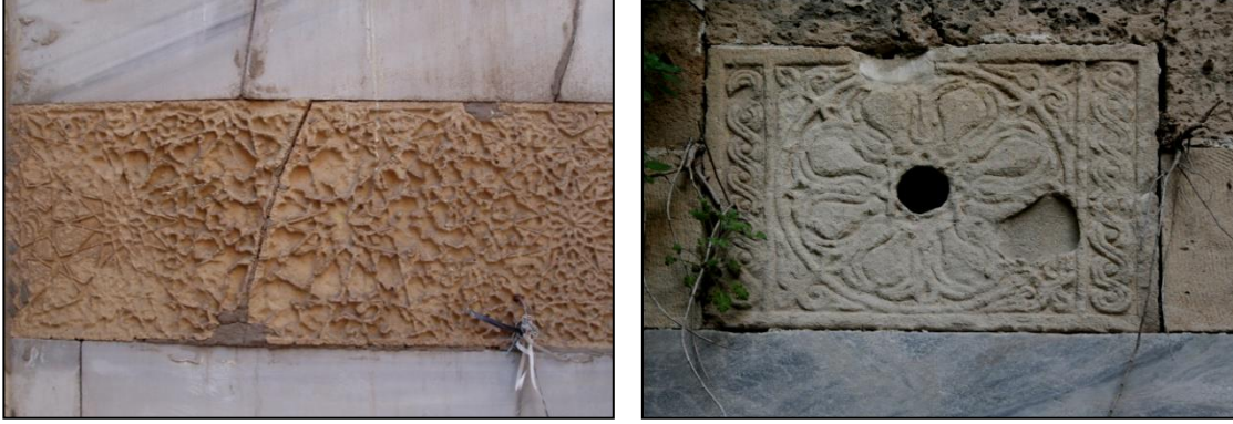
شكل(28): نماذج توضح تأكل أجزاء من الزخارف نتيجة قلة الترميم
