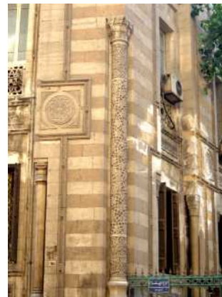
عمود مدمج من أصل الكتلة البنائية لزاوية المبنى . مبنى وزارة الأوقاف شارع شريف.
