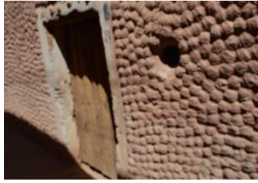
اللوحه(03)واجهة منزل تقليدي بطوب اليبدين -من تصوير الباحث من قصر أولاد أوثن-
