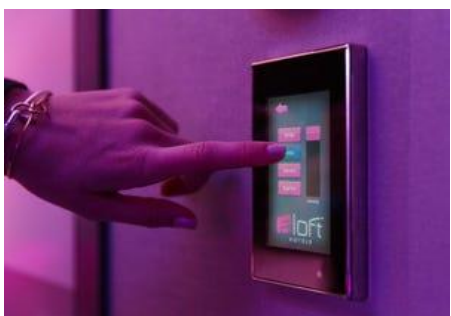
صورة رقم (3) توضح تفعيل خدمة ضبط رغبات النزلاء من الحرارة الإضاءة
