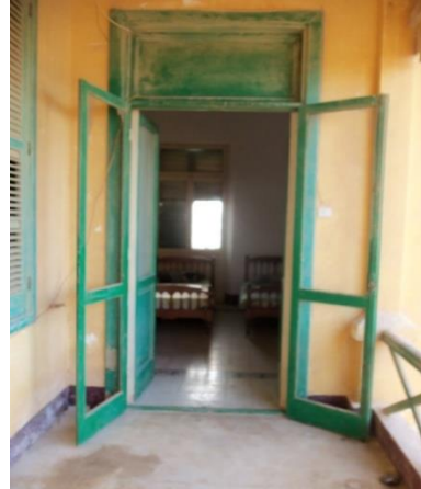
(لوحة ٣٣) فتحة بلكونة من الغرفة بالنهاية الشمالية الشرقية المؤدية للشرفة الشمالية الغربية بالطابق الثاني باستراحة شركة الفوسفات بالقصير (تصوير الباحث)
